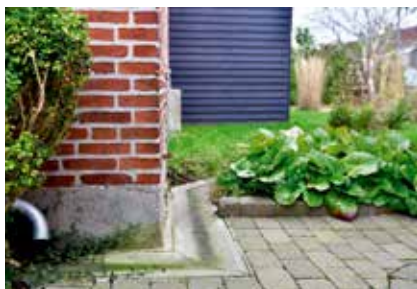
Regnvattnet från baksidan av huset rinner ut i ett avsågat stuprör och ner i en ränna som löper runt husknuten ...
