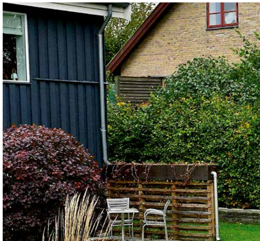
Regnvatten från hustaket leds via en låda med växter, vidare till regnvattenrännan och sedan vidare till regnbädden.
